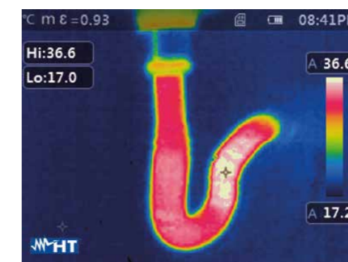
In foto: termogramma di un sifone occluso acquisito con THT80.
