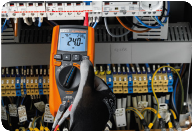
Verifica tempo e corrente d'intervento RCD.
