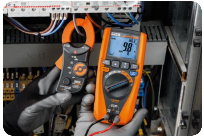
Misura di armoniche di corrente.
